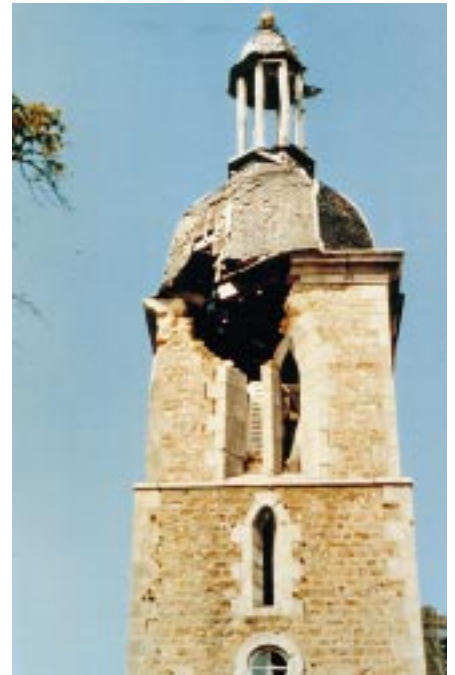
Clocher de pierre éventré par la foudre (Photo EDF)
